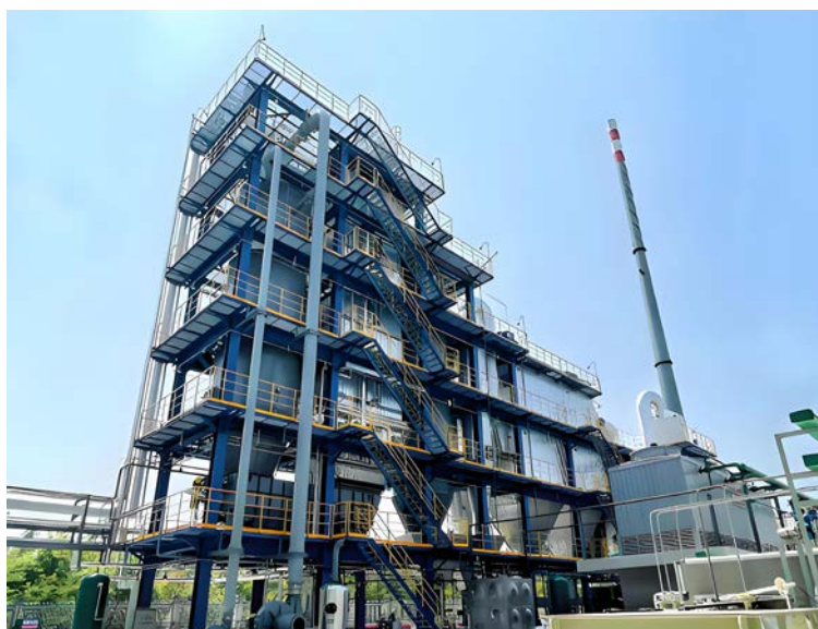
廢液廢水焚燒系統及配套的煙氣淨化裝置
